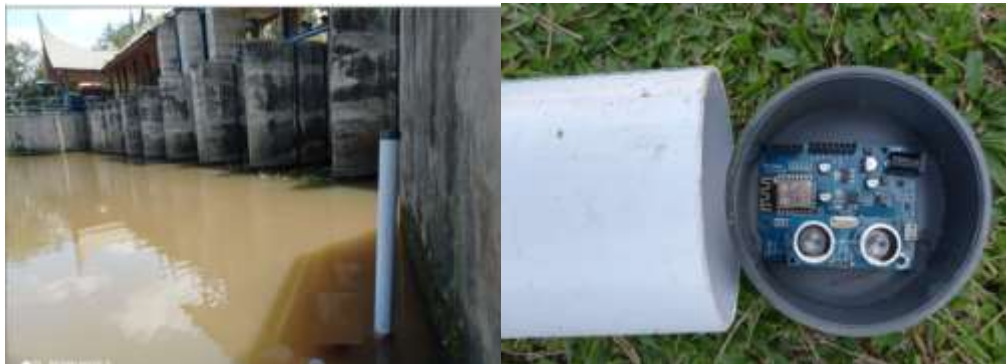
Gambar 7. Sensor Ultrasonic dan pemasangan sebagai pengukur ketinggian air bendungan
